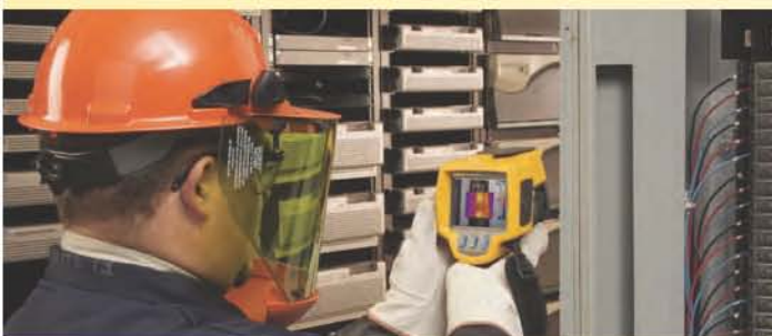
Электрические соединения с ненормально высокой температурой являются не только возможным ранним предупреждением об отказе и угрозе безопасности, но так же потребляют дополнительную энергию.
